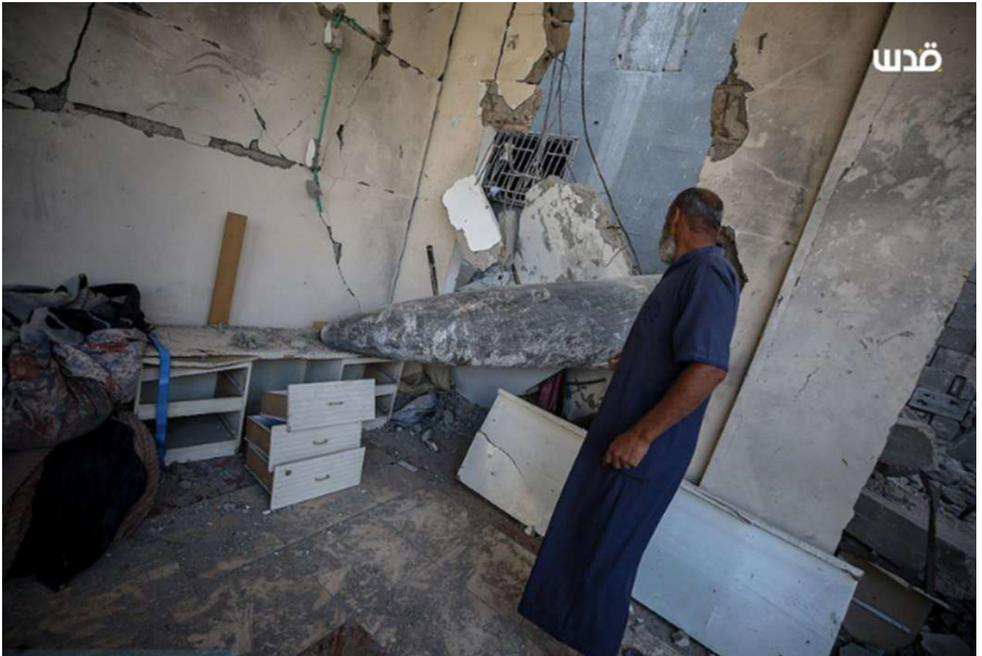
ガザでの大規模な破壊。(Photo: via QNN)
